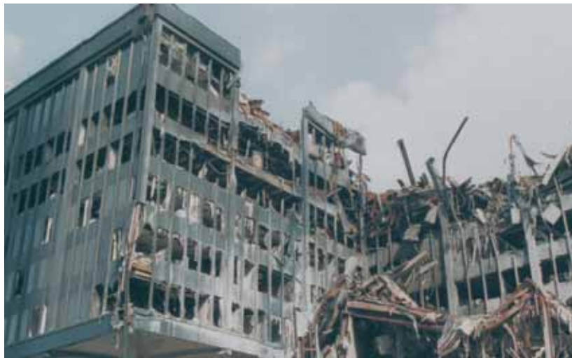
Het karkas van wTC-6 staat na de hevige brand nog overeind. Vóór 11 september was nog nooit een gebouw met een stalen structuur door brand ingestort.
